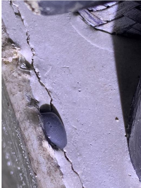
圖 3-7 L2-8G 貫穿件防水膠破損處滲漏情形
