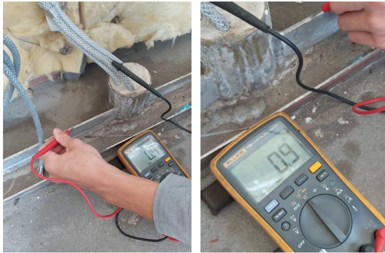
圖 2-12 貫穿件與電纜間電阻測量
