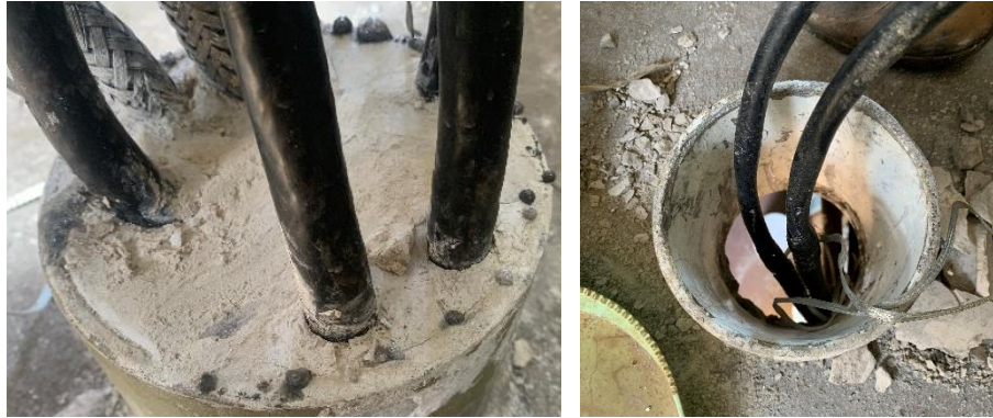
圖 3-1 左圖為有鎧甲電纜造成之腐蝕現象
