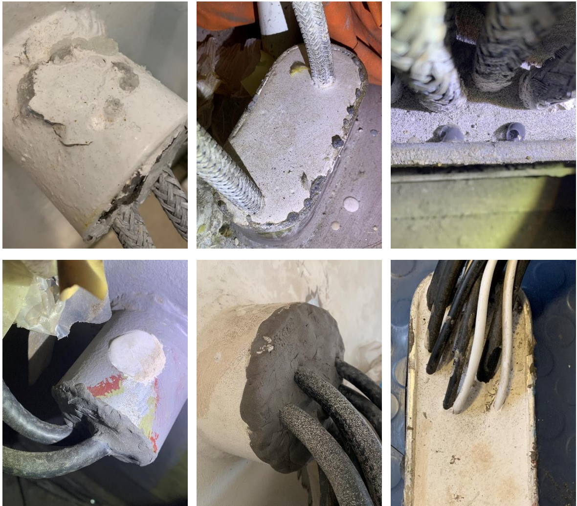
圖 2-10 貫穿之電纜有無橡膠層所造成之變化
