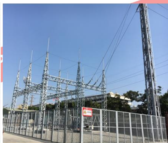
特高壓升壓站完工照
